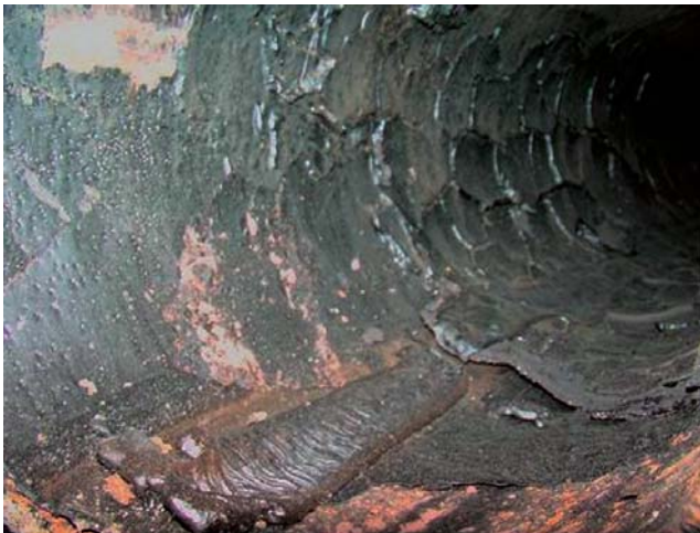
Hình 4. Lắng đọng paraffin trong đường ống dẫn dầu từ Bạch Hổ sang FSO-3 mỏ Rồng (lấy trong thời gian sửa chữa Plem UBN-3)
