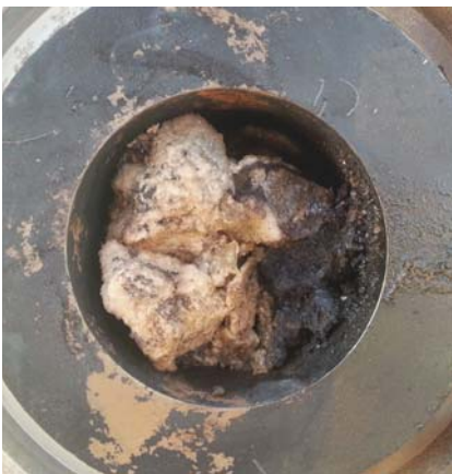
Hình 2. Muối lắng đọng và gây tắc dòng chảy tại choke valve
