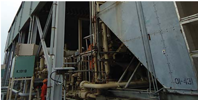
Hình 11. Trạm nén khí đầu vào Nhà máy xử lý khí Dinh Cổ
