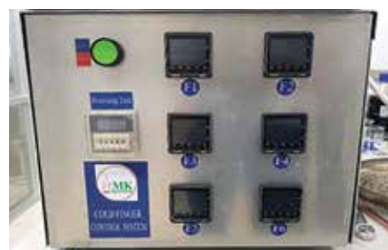
Hình 10. Trung tâm xử lý tín hiệu, điều khiển hệ thống
