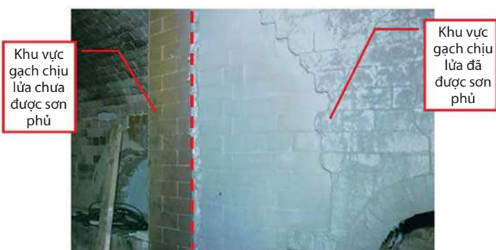
Hình 7. Khu vực thành lò chưa và đã được sơn phủ lớp tăng độ bức xạ (High-Emissivity Coating)
